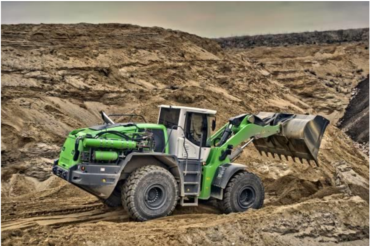
Pressefoto1: Die Ingenieure der TU Dresden errichten in einem Verbundprojekt die erste 5G-Testbaustelle. Hier sollen intelligente Baumaschinen erprobt werden. Foto: Oliver Koch/TU Dresden
